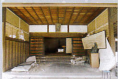
内外壁の剥落・亀裂
