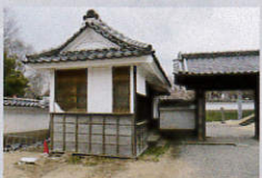
内外壁の剥落・亀裂
